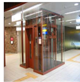
エレベーター
