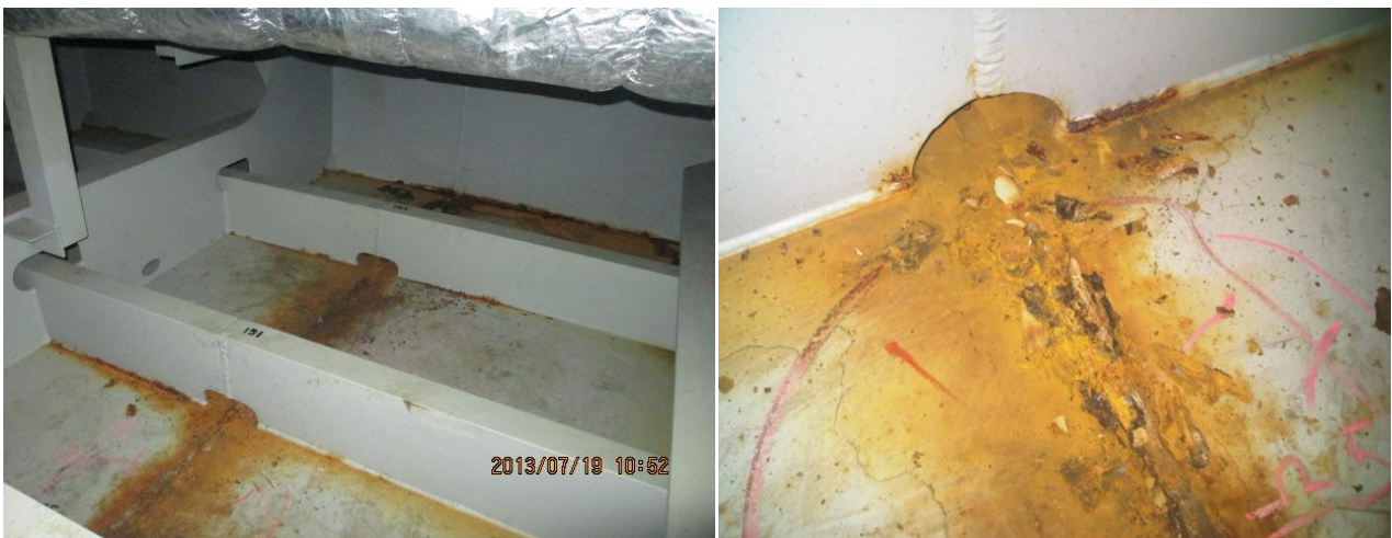
図 4. 3 バット継手部の塗装の割れと錆（商船三井提供）
