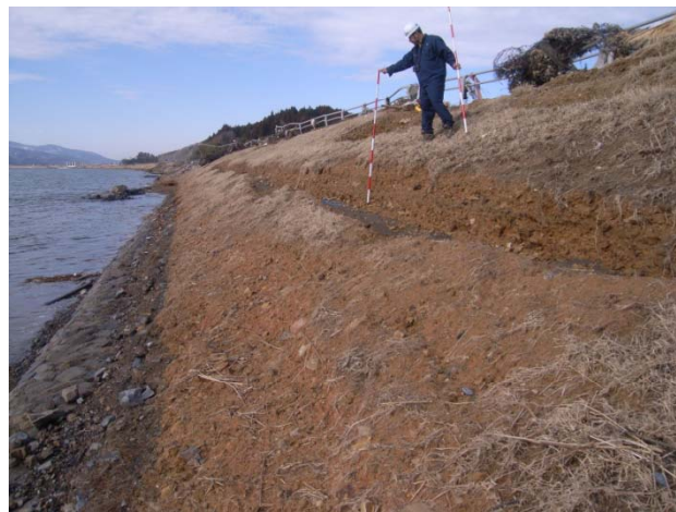
津波遡上時の高流速によって侵食された堤防表のり面
