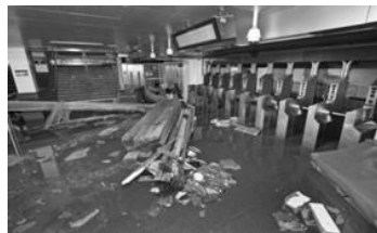
ハリケーン・サンディで被災したNY地下鉄駅の浸水状況 ©MTA
