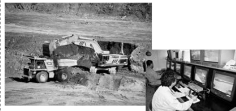
遠隔操作の状況
