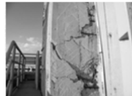
水門の門柱部のコンクリ剥離
