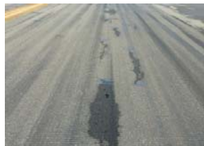
(老朽化した基本施設舗装)
