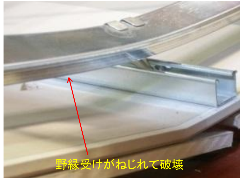
＜野縁受け方向試験体の破壊状況＞ JIS材 300ピッチ 正側加力(試験体U-4)
