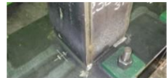
写真1 局部座屈 (HH-14M-C3)
