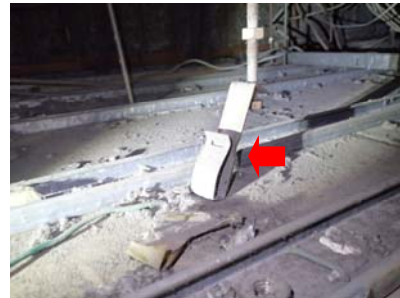
ハンガーの脱落
