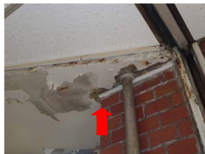
天井の漏水跡
