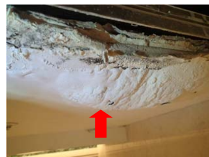
漏水による天井材の劣化
