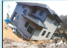
宅地の滑動崩落 (仙台市青葉区)
