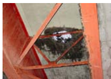
(橋梁の抜け落ち)
