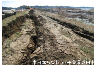
東日本被災状況(千葉県成田市)
