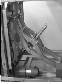
換気口浸水防止機
