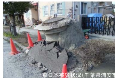
東日本被災状況(千葉県浦安市)
