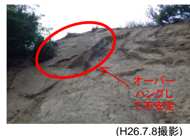
被害状況③不安定部の残存
