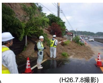
被害状況②土砂流出
