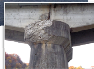
主桁・橋脚の損傷
