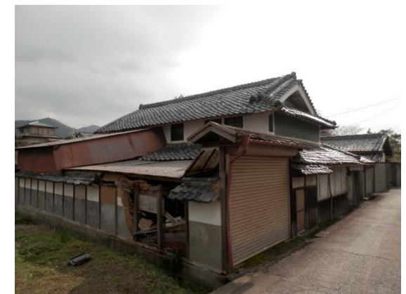
一部倒壊している空き家 (檜前集落)
