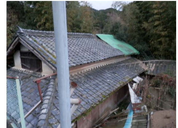
一部倒壊している空き家 (細川集落)
