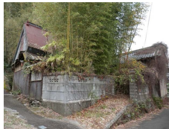
敷地が荒れ、倒壊している空き家 (大根田集落)
