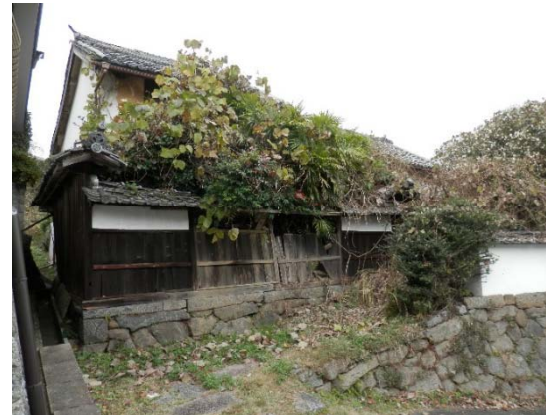
損傷が激しい空き家 (越集落)
