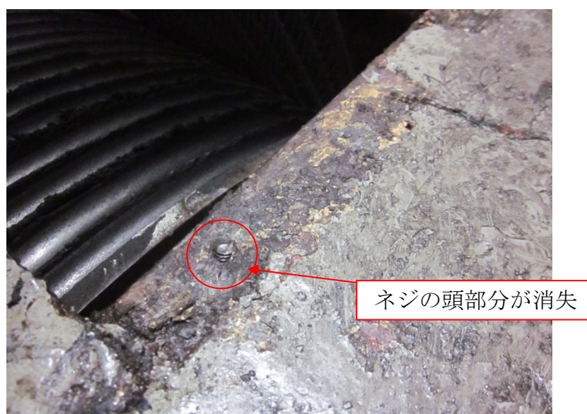
写真6. ふさぎ板を止めていたネジ破断状態
