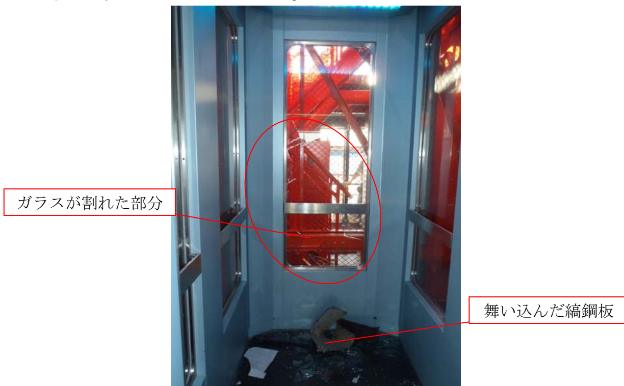
写真2. 事故発生後のかご内の様子 (東京タワーより提供)
