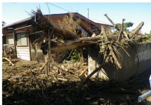
流木による家屋被害（東京都大島町）
