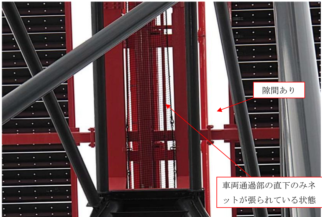
写真8. 落下物防止ネット
