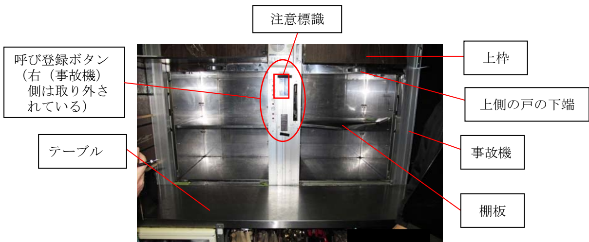
写真1 小荷物専用昇降機の設置状況
