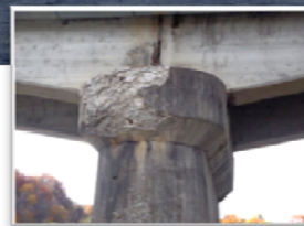
主桁・橋脚の損傷
