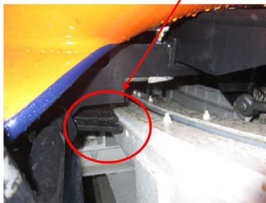
写真9. チェーントラフ干渉部分
