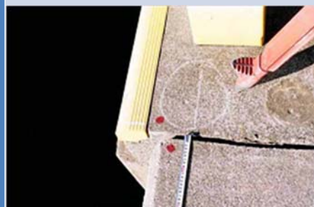
隣接スパンとの間に10～20cm程度の凹凸がある。
