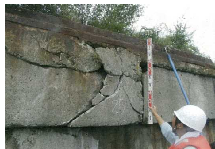
上部工割れ(43年経過)
