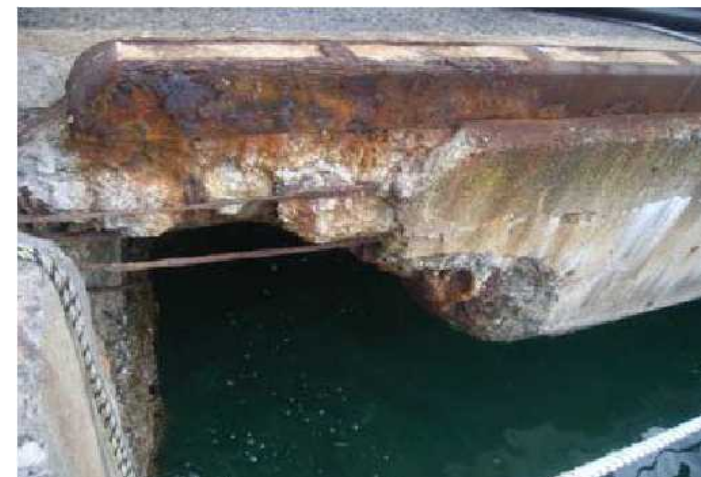
上部工欠損(37年経過)
