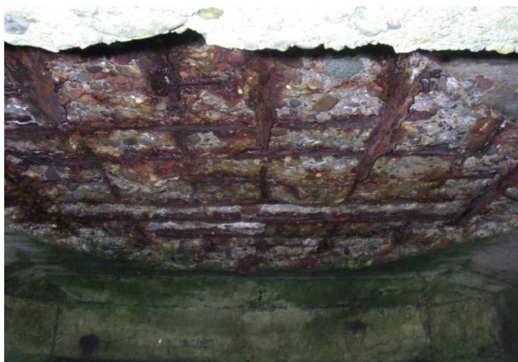
栈橋床版下面鉄筋露出(50年経過)
