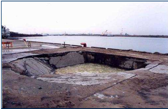
裏込め土の吸出しによるエプロンの陥没
