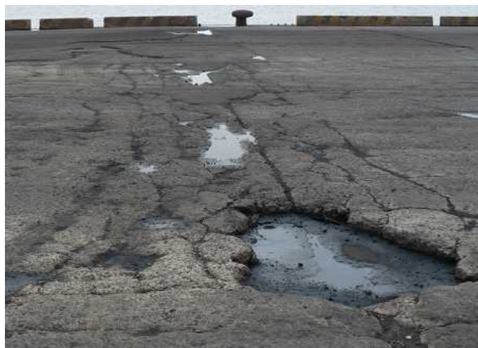
エプロンひび割れ、剥離(34年経過)
