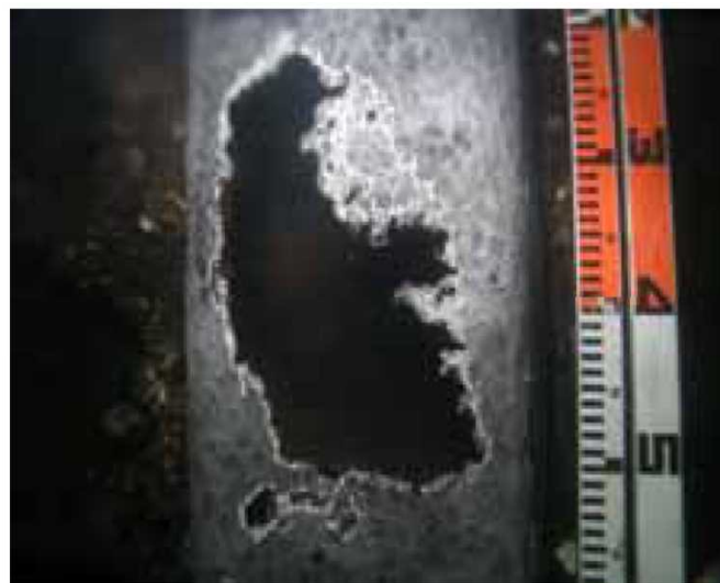
腐食による 鋼矢板開孔(44年経過)
