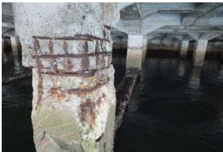
栈橋脚柱部鉄筋露出(48年経過)
