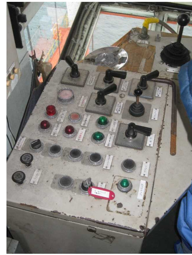
スイッチ類の点検
