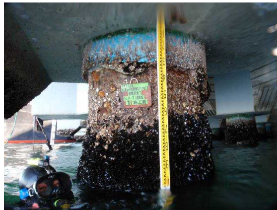
① 棧橋脚部劣化状況
