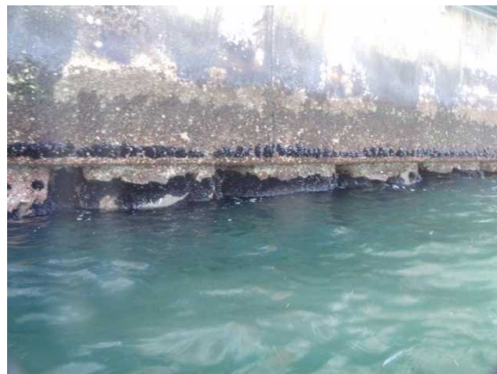
① 矢板部劣化状況
