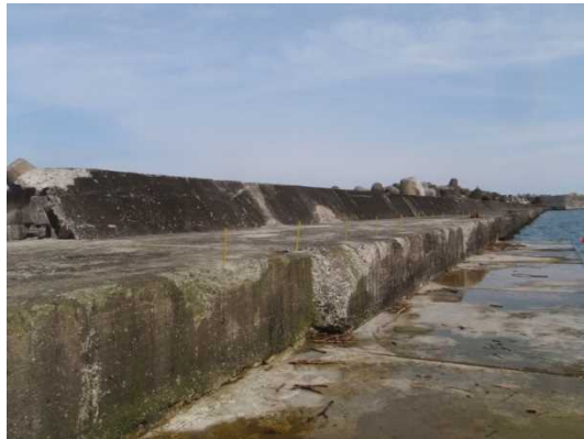
①上部工老朽化状況
