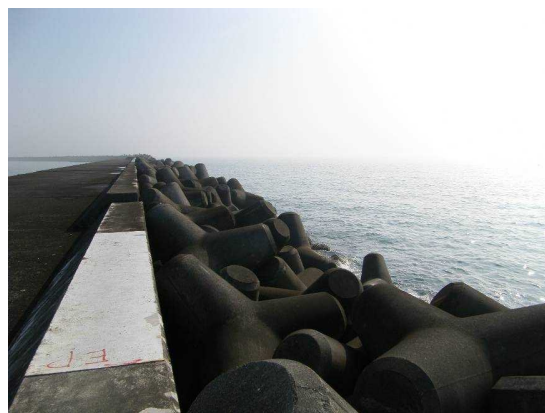
①消波ブロック飛散状況
