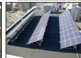
太陽光発電 徳島第一合同庁舎
