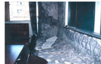
内部の被災状況
