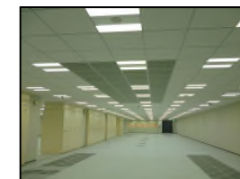
LED照明 気象庁清瀬庁舎
