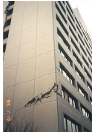
外部の被災状況
