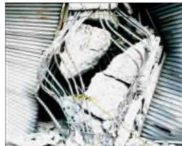
店舗1階柱の圧壊
