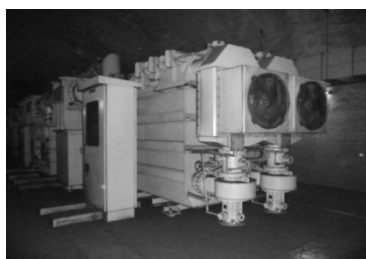
【変電所設備の一例】
