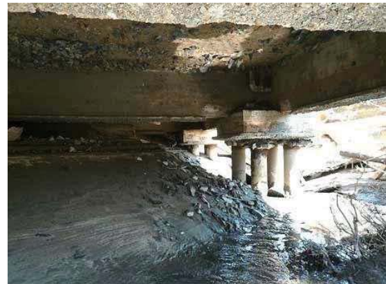
建物基礎が露出
