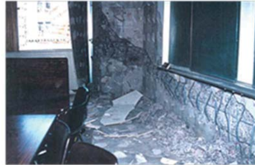
内部の被災状況
