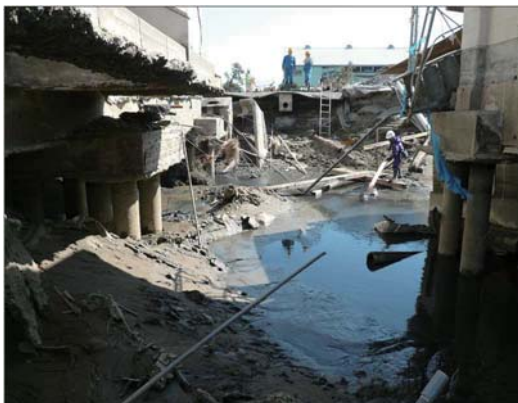
庁舎周囲の地盤流出
