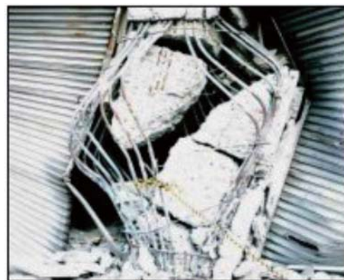
店舗1階柱の圧壊
