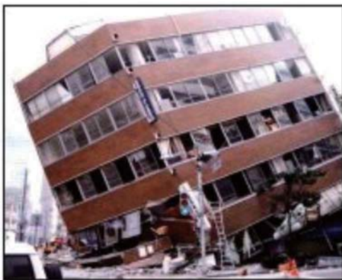
事務所ビル1, 2階の崩壊
