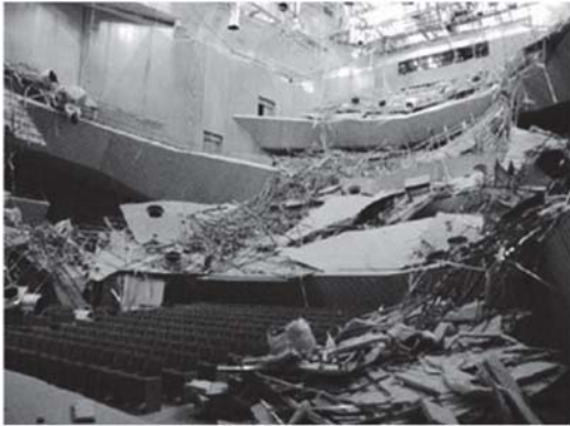
ホール天井の脱落
