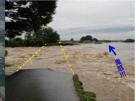
被災状況(拡大写真)
