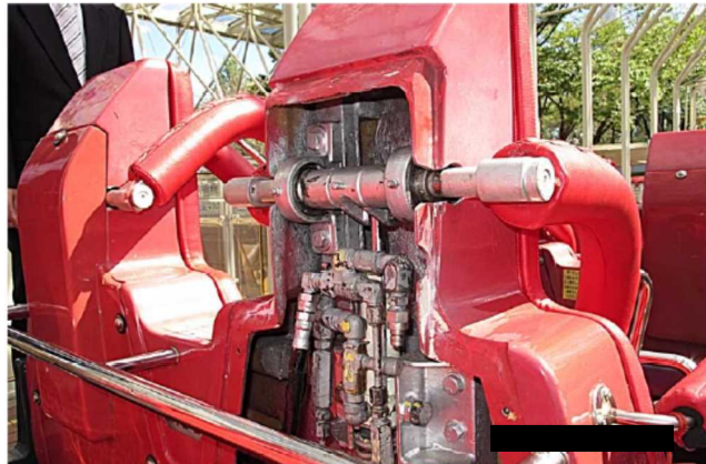
写真3 拘束装置ロック部
