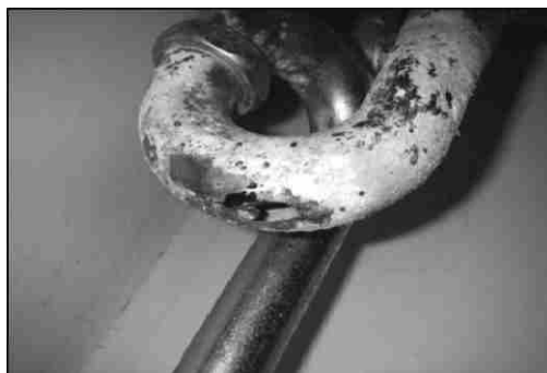
排水トラップの劣化
