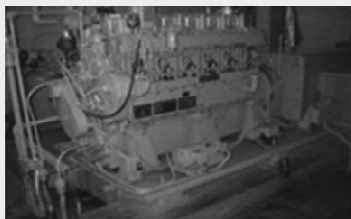
自家発電設備の故障
