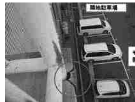
屋外階段手すり部の異常
