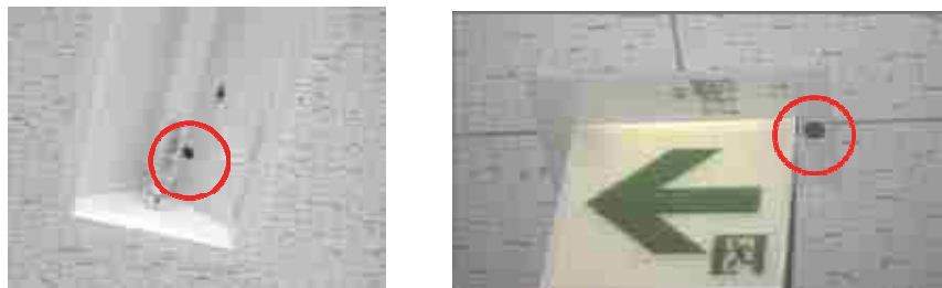
非常用照明器具(左)と誘導灯(右)のバッテリーチェックランプ
