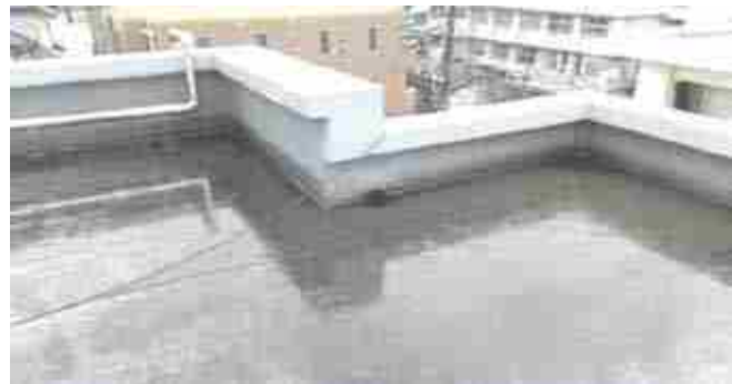
排水口が詰まり雨水が溜まった屋上
