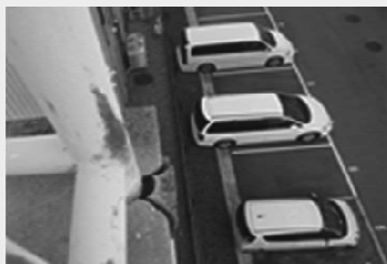
手摺り支柱部モルタルの浮き
