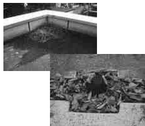
ルーフトレンの清掃不良
