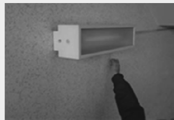
非常用照明の不点灯
