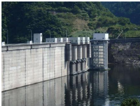
ダム堤体上流面の状況 (EL. 106m付近)
