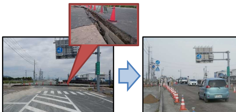
臨港道路に生じた段差（左）と復旧状況（右）
