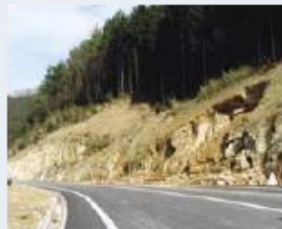
部分的に崩壊した法面
