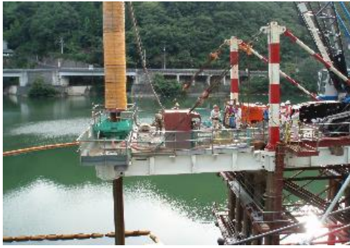
写真一 片持ち架設と杭打ち状況 (水上、斜面上に導材設置が不要)
