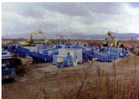
写真-1 設備全景
