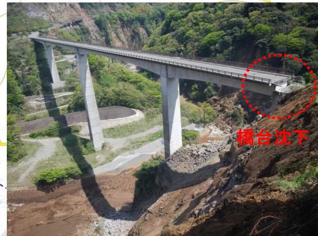
阿蘇長陽大橋の被災状況
