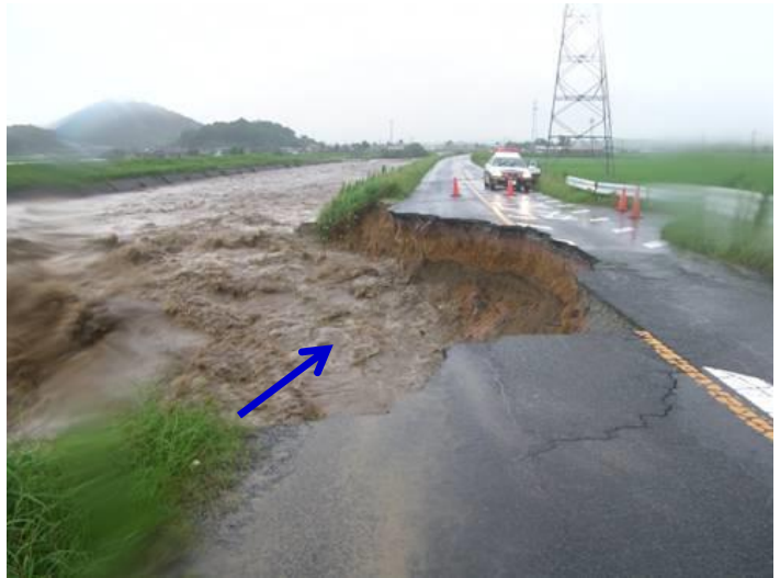
堰の流失時に侵食された堤防
