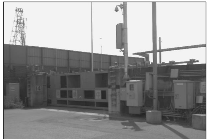
陸閘の電動化：尼崎西宮芦屋港海岸
