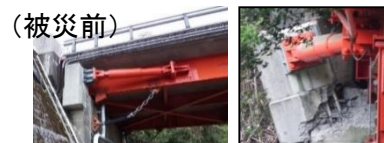
制震ダンパー取付部の損傷
