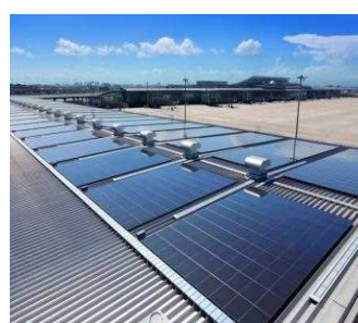
羽田空港・貨物ターミナル (国際線・2,000kW規模)
