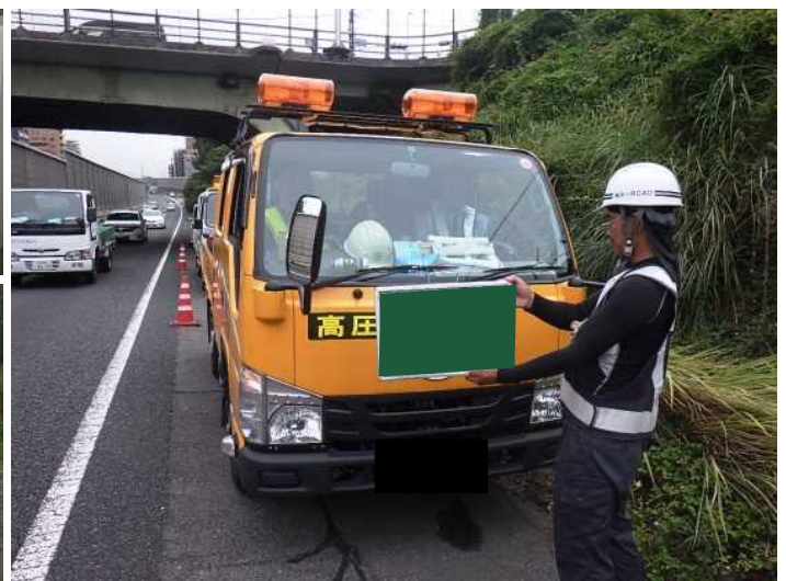
▲保守工事等、現場に休憩所が確保できない場合の工夫 (車内での休憩)
