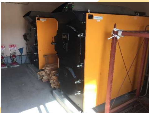
真庭市 中和地区 薪ボイラー
