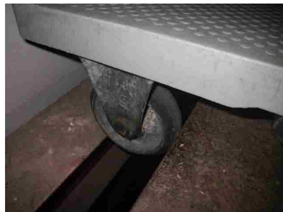
写真17 かごと昇降路内の梁との間に 台車前輪を置いた状態 (かごを下降させる前)
