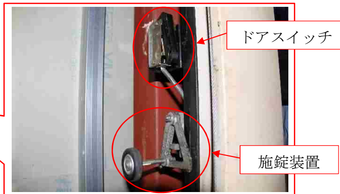
写真6 ドアスイッチ、施錠装置
