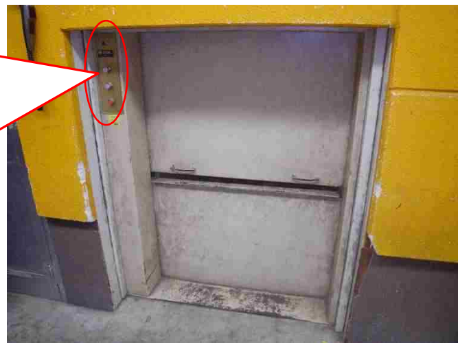
写真10 呼び登録ボタン取り付け位置（1階）
