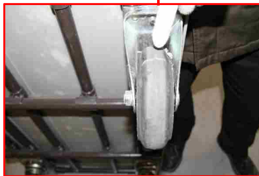
写真20 台車左前輪の圧痕 (昇降路内梁エッジ部への食い込み)
