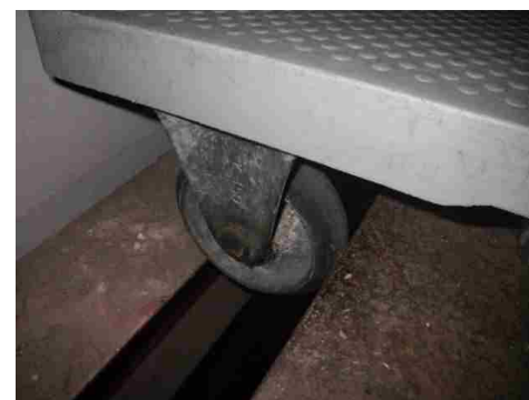
写真8 かごと昇降路内の梁との間に台車前輪を置いた状態
