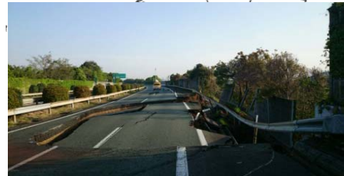
②九州自動車道（益城熊本空港IC～嘉島JCT） 盛土の崩壊
