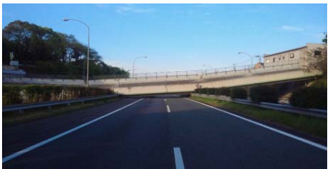
③九州自動車道（益城バスストップ付近） 本線上の跨道橋の落橋
