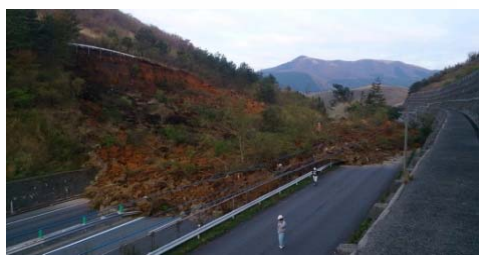
①大分自動車道（由布岳PA付近） 道路路面の崩落
