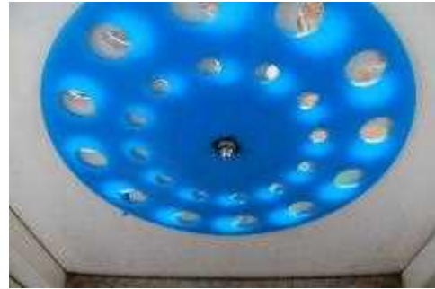
写真6 通気回転窓の拡大写真
