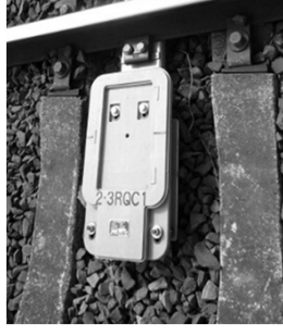
電路設備 (自動列車停止装置(ATS))
