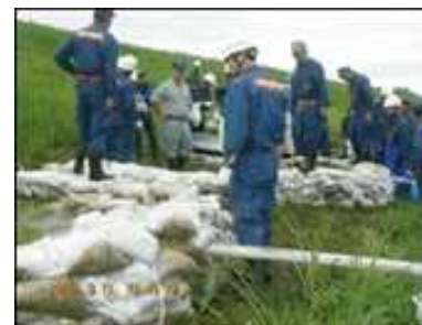
団員による豪雨時の水防活動 （水防工法による堤防の漏水対策）
