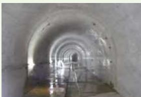
善徳地すべり 排水トンネル
